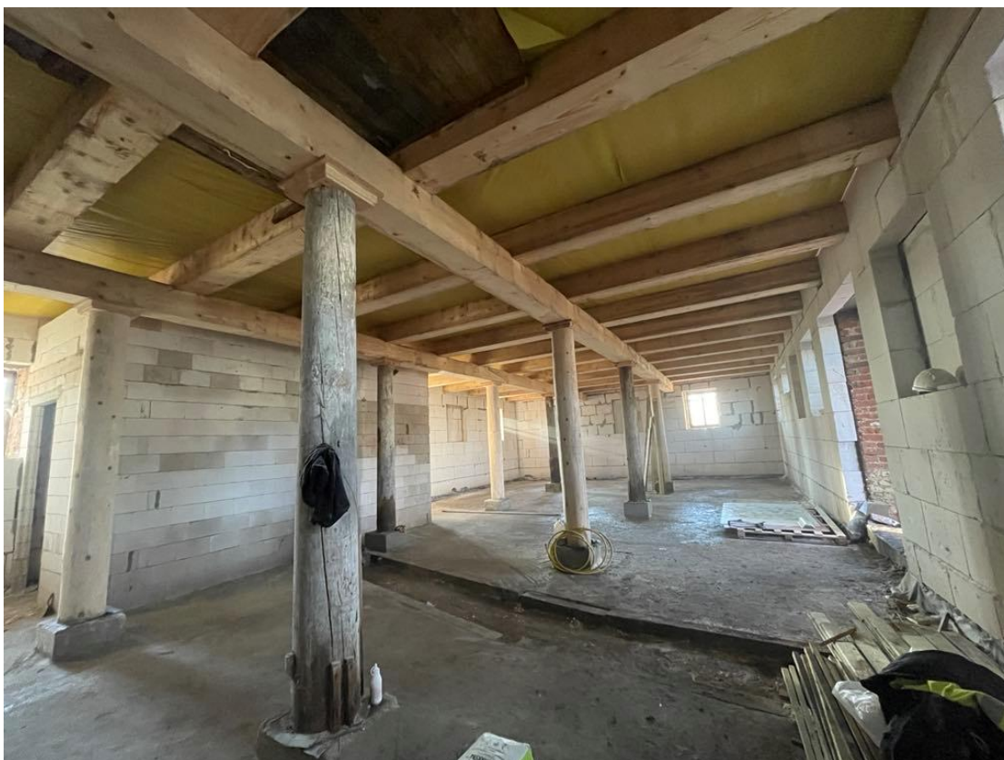
Fot. 5-6. Zamontowano nowe belki stropowe, na wzór dawnych, oryginalnych. Wewnątrz spichrza, na nowych fundamentach, postawiono oryginalne i nowe kolumny z nowymi głowicami. Wylano wylewkę cementową.
