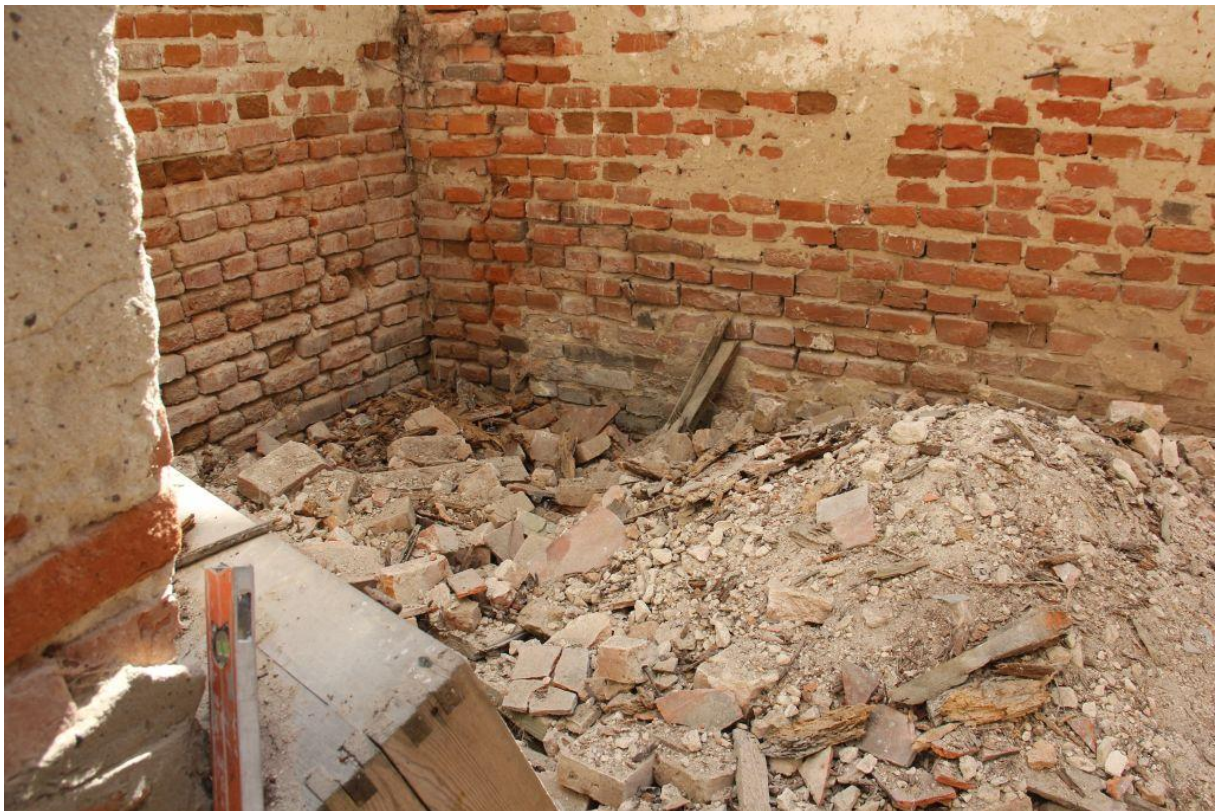
Fot. Ściany z licznymi pęknięciami spowodowanymi zawaleniem się dachu. Tynk oraz pobiałe odspajają się od lica ściany. Widoczne ubytki w cegle oraz fudze.
