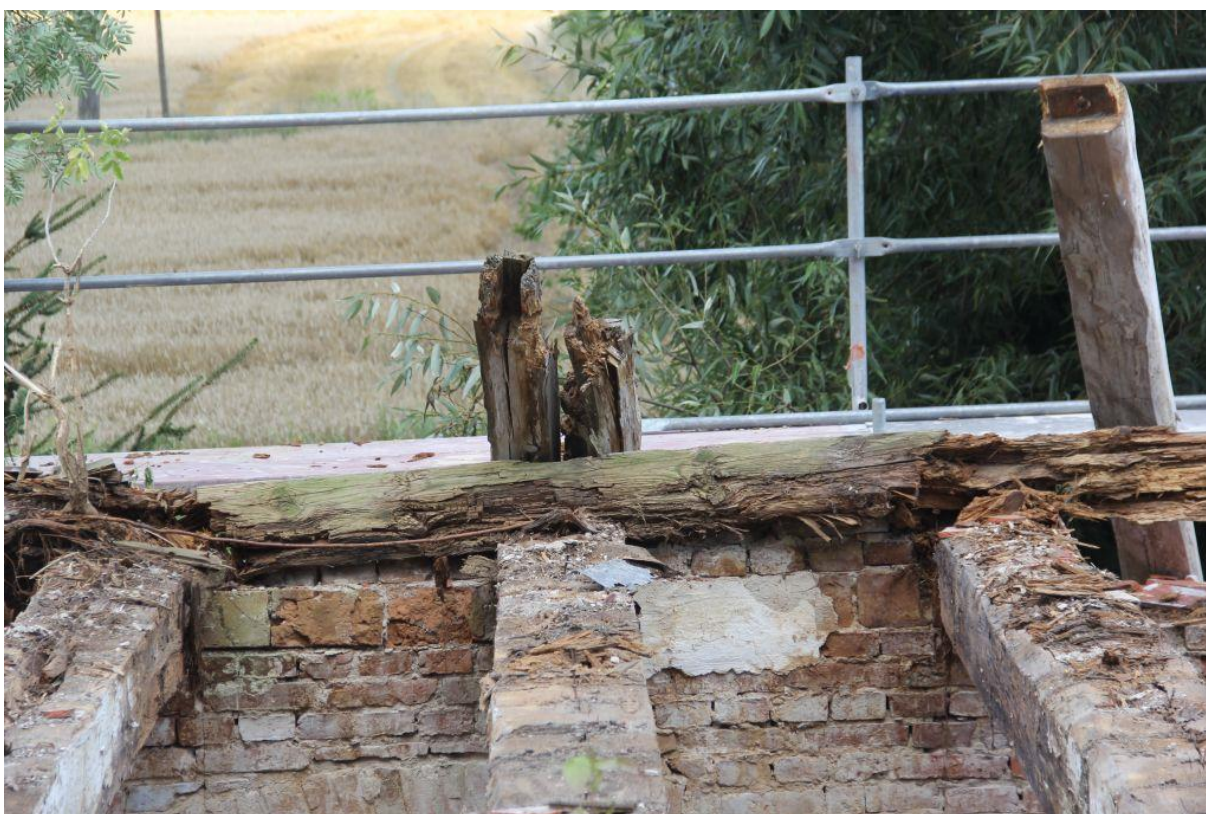
Fot. Belki stropowe w bardzo złym stanie zachowania, nie spełniają swojej funkcji konstrukcji dachu. Widoczna na belkach korozja biologiczna. Belki są spróchniałe lub zgnite. Należy wymienić belki stropowe na nowe.
