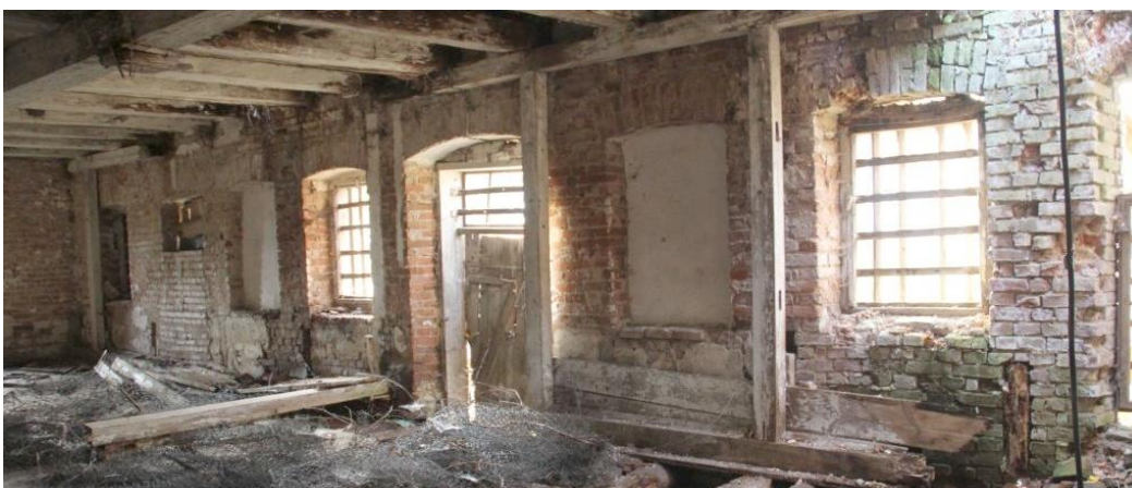
Fot. Stan zachowania otworów okiennych w 2021 r.
