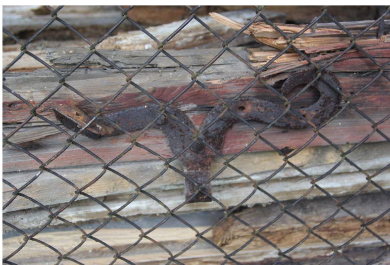
Fot. Należy wykonać nowe drzwi z desek wzorując się na drzwiach zastanych. Należy w drzwiach umieścić klamkę i zamek historyczny.
