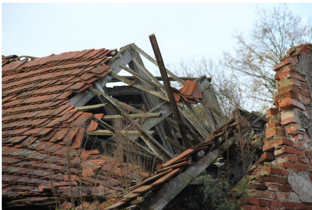
Fot. Stan zachowania więzby dachowej spichrza w 2021 r.
