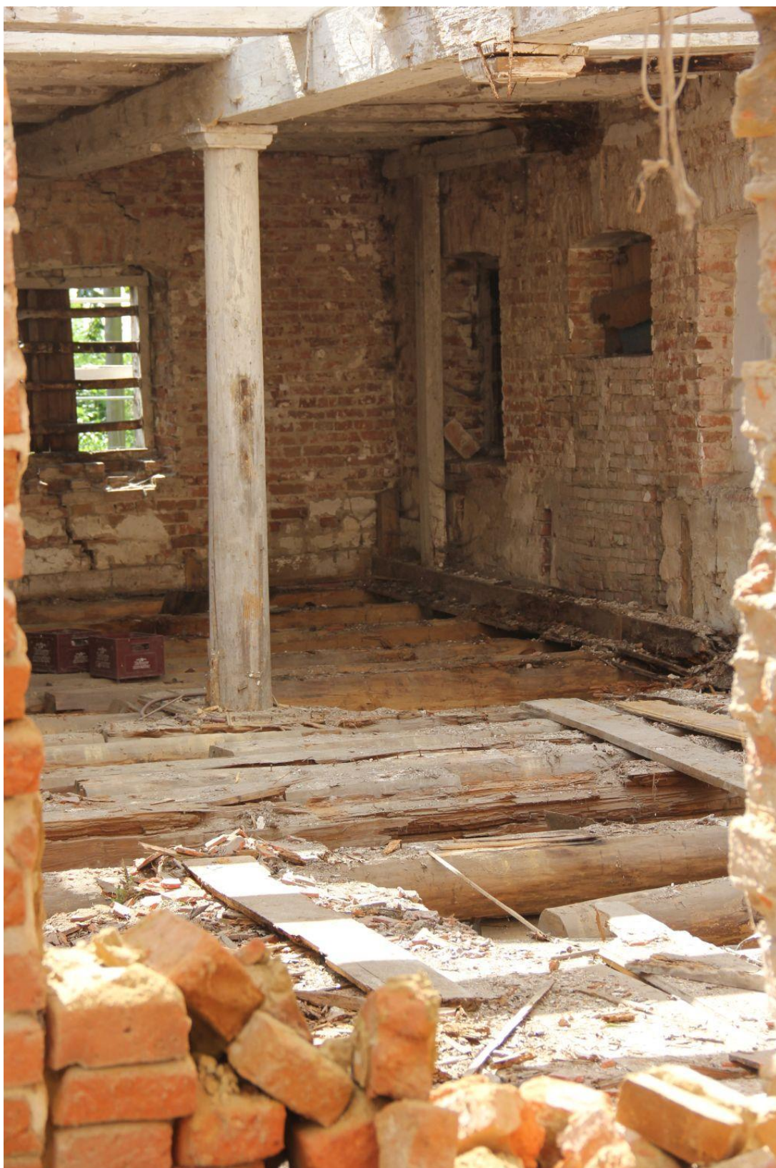
Fot. Zachowały się 4 słupy z pośród 8. Widoczne są ślady na belce nośnej po głowicach kolumn. Należy zdemontować słupy i ocenić ich stan czy nadają się do ponownego montażu.
