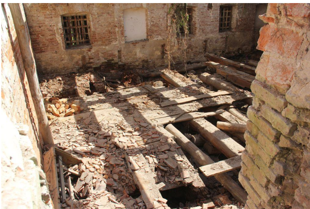
Fot. Bardzo zły stan belek podłogowych oraz desek. Deski oraz belki zarywiają się są bardzo słabe. Widoczna korozja biologiczna spowodowana przez lata przeciekającym dachem.
