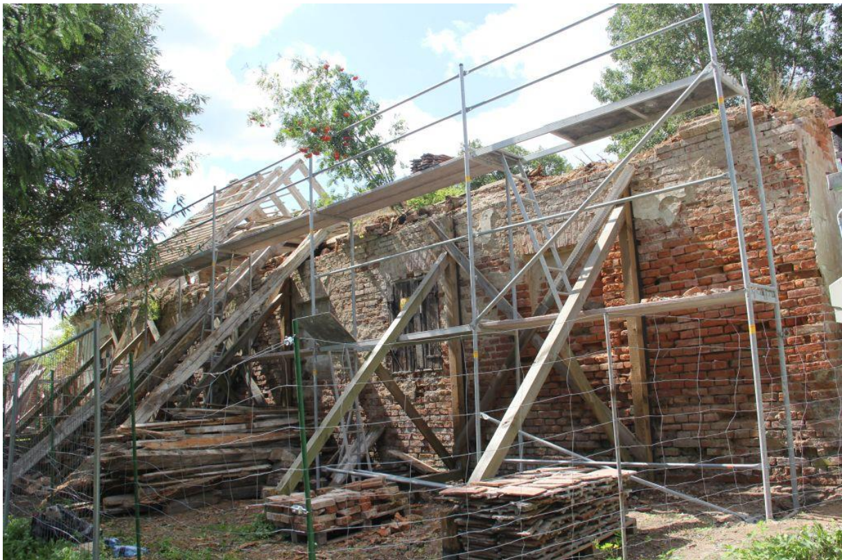
Fot. Ściany z licznymi pęknięciami spowodowanymi zawaleniem się dachu. Widoczne ubytki w cegle oraz fudze. Na ceglach widoczne pozostałości oryginalnego tynku.
