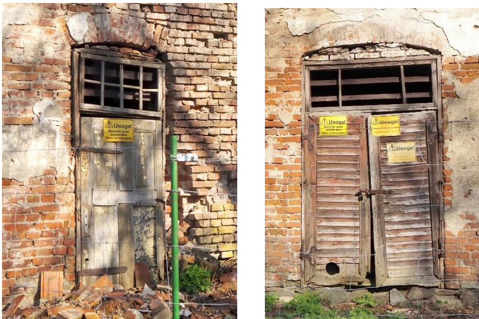
Fot. Obecnie skrzydła drzwi po lewej stronie są wtórne. Po prawej stronie zachowały się oryginalne drzwi z żaluzjowym opierzeniem płycin oraz okuciami.
