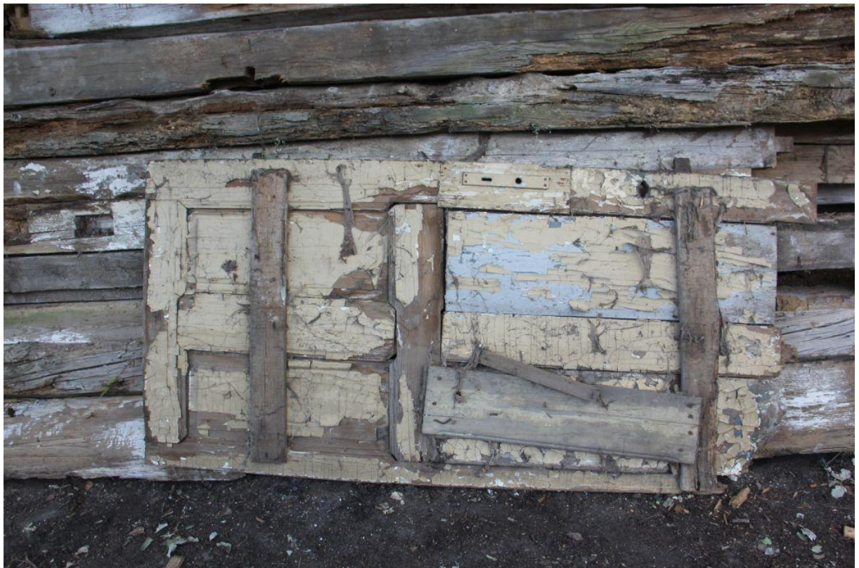
Fot. Drzwi boczne są drzwiami wtórnymi. Należy wykonać nowe drzwi z desek wzorując się na drzwiach zastanych głównych. Należy w drzwiach umieścić klamkę i zamek historyczny.
